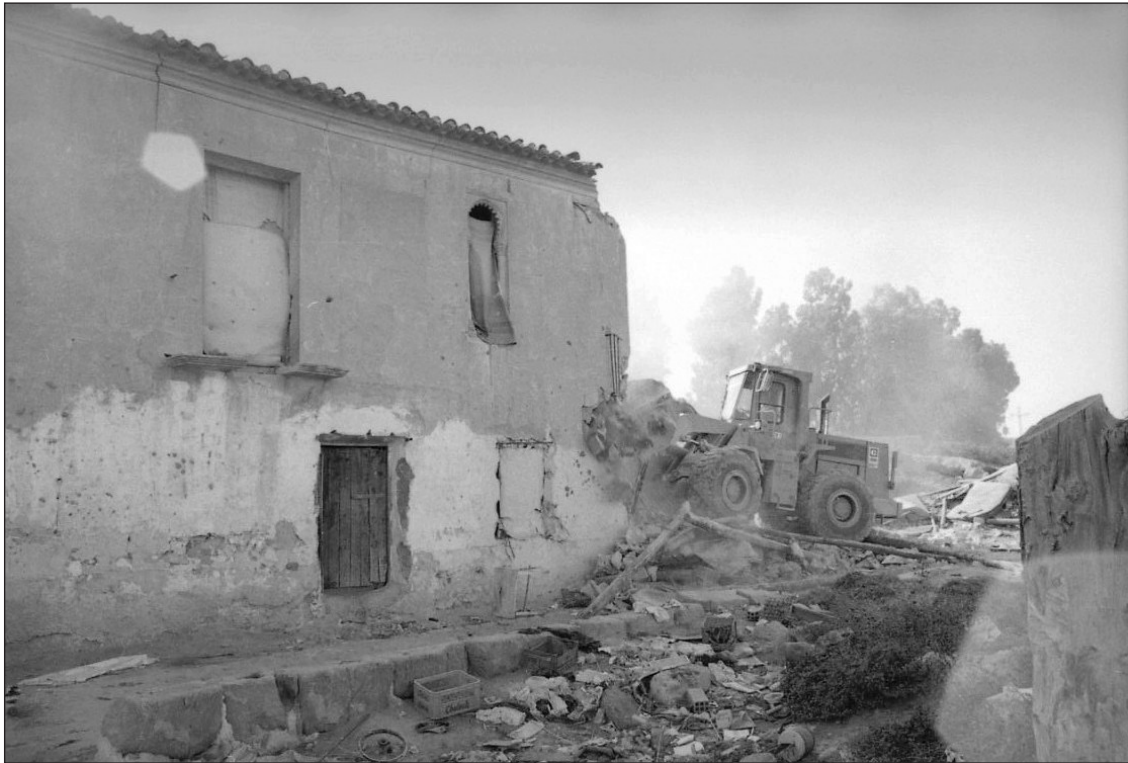
Lámina 4. Detalle del poyete de la casa del Huerto de la Rueda antes de ser destruido
